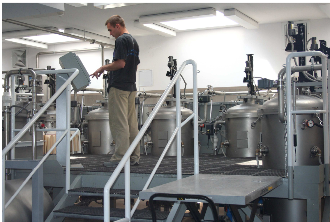
obr.3 Pohled na vertikální reakční komory, vpředu vlevo - ruční ovládání procesu
