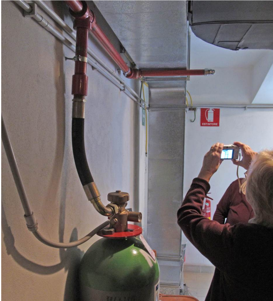
Obr. 6 Plynové hasební zařízení v nových depozitářích.
